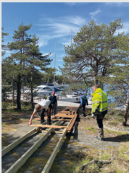
Kulkulaakonkia rakentamassa Hannu Koskimies, Rainer Blomqvist, Jerry Lehtinen ja Markku Hämmäläinen. ANSU BLOMQVIST
