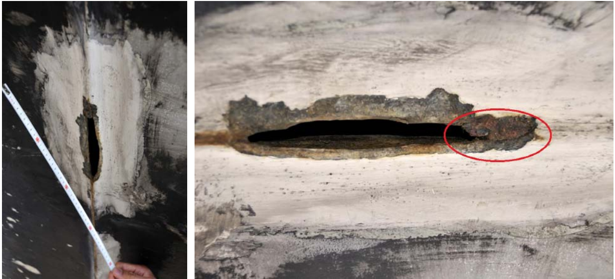
Kuva 6. Veneen pohjassa ollut reikä.
