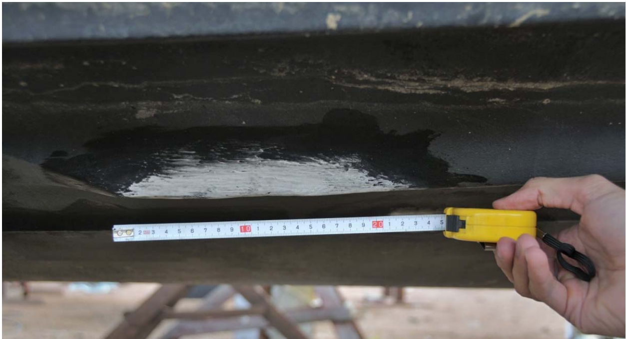
Kuva 5. Eräs pohjasta löytynyt korjattu kohta. Nousulistan muoto aaltoilee kertoen, että rakenne ei ole alkuperäinen Marinon muotista saatu muoto. Korjaus on virheellisesti tehty osittain eliönestomaalin päälle. Tämä näkyy mm. siinä, että liuotteet ovat vaikuttaneet mustaan maaliin korjauskohdan ympäristössä. Korjauskohdan päälle on maalattu valkoista liukasta väriä joka todennäköisesti on topcoatia. Valkoinen sävy on selvästi vaaleampi ja kylmempi kuin veneen gelcoatin sävy. Musta eliönestomaali on todennäköisesti irronnut valkoisesta paikkamaalista jo kauan ennen veneen uppoamista, sillä maali ei tunnetusti pysy kiinni topcoatissa.
