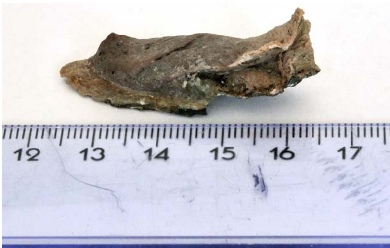
Kuva 7. Reiän toisesta päästä irti koputettu kitinpala. Kitin muodosta voi päätellä, että kittiä on levitetty vain ulkoa päin ja että se on pääosin pysynyt paikallaan ainoastaan reiän yli ulottuneen hyvin ohuen laippamaisen muotonsa turvin. Tällainen korjaus ei ole asiallinen eikä se voi olla kestävä.
